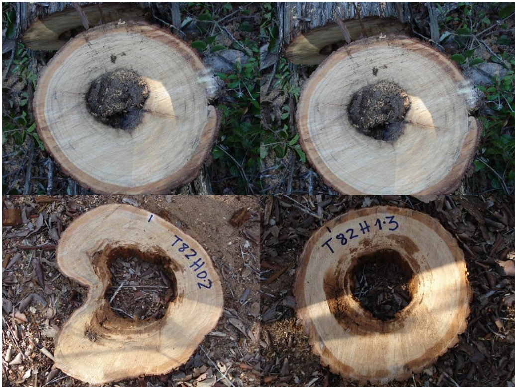
Figura 3. Cerne deteriorado do Cimirre
